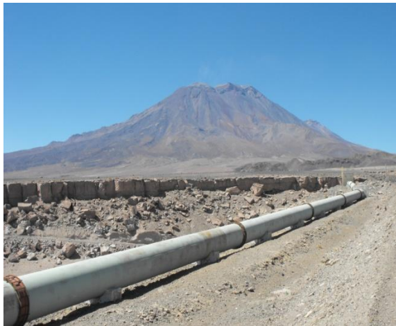
Tuberías que trasladan el agua en la cuenca del río San Pedro, a un costado del pueblo (2010)
